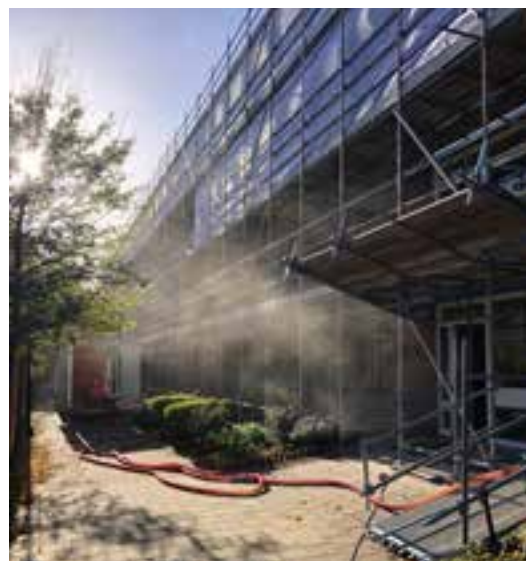
In november zijn wij gestart met een renovatieproject aan de Eikenlaan in Woerden.
